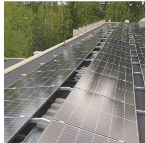
Kuva 17. Kelluva Itä-länsi asennus. Paneelirivit voivat olla lähekkäinkin varjostamatta toisiaan. Solarvoima
