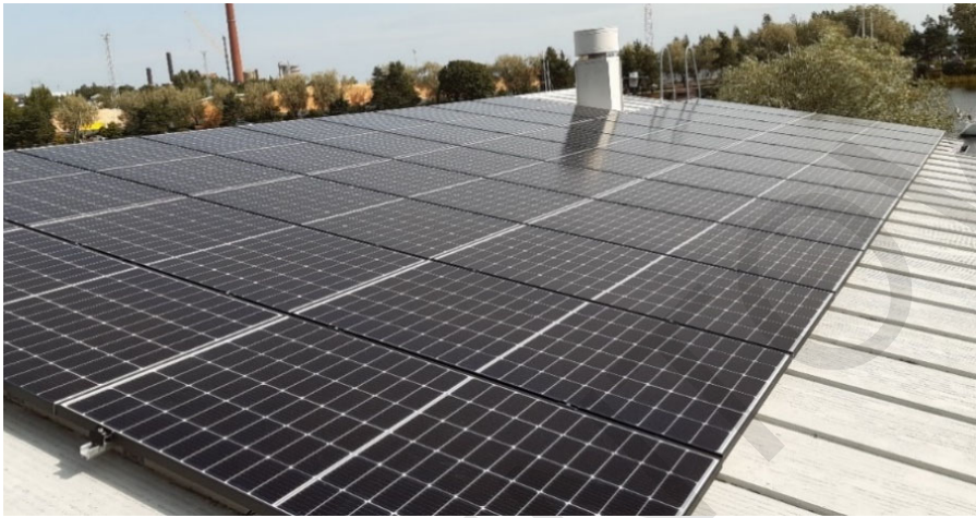
Kuva 8. Half-cut (black) paneeleja (33 kpl) asennettuna Kotkan Sapokan vierasvenesataman saunan pulpettikatolle kesällä 2021. Kuva Teemu Heikkinen
