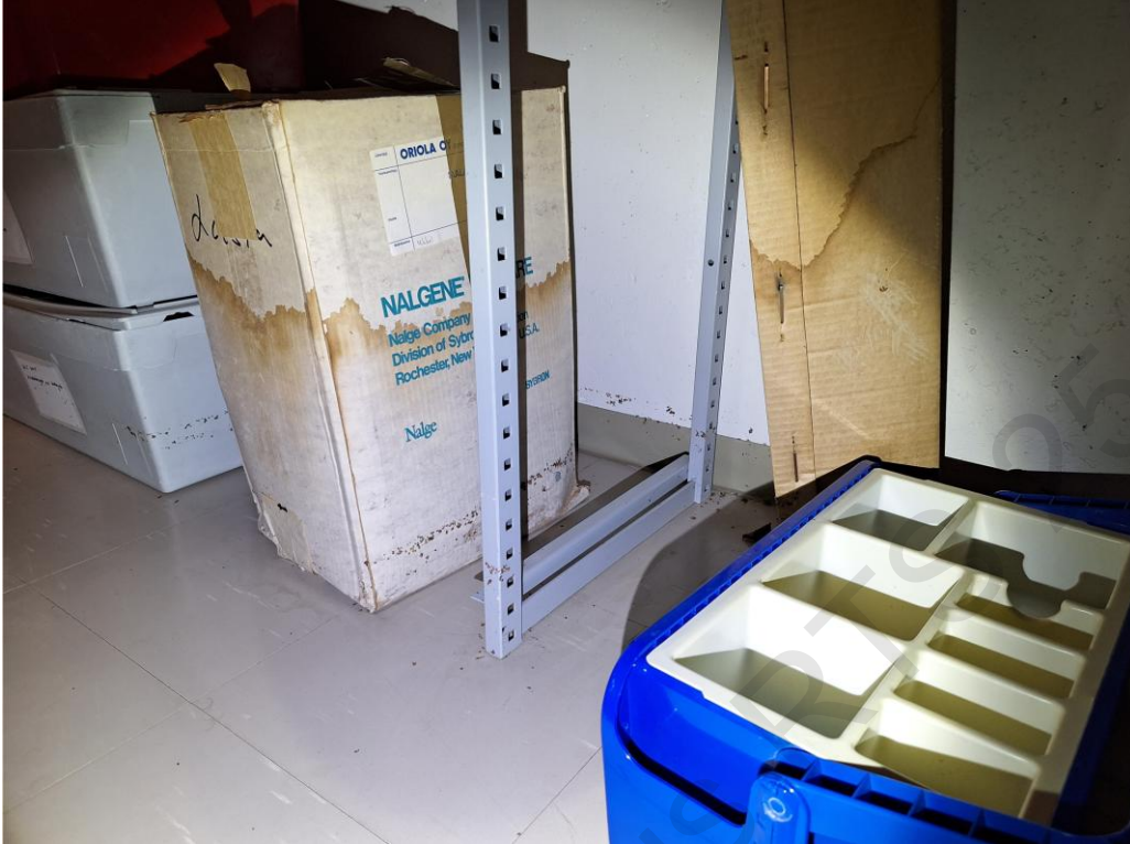
Kuva 4. Varastossa säilytettyihin pahvilaatikoihin on jäänyt tulvavedestä johtuen erilaisia jälkiä. Kuvassa nähdään vedenpinnan korkeus roskien kerääntymisenä noin 50 mm:n korkeudelle sekä kapillaarisen siirtymän korkeus pahvissa.
