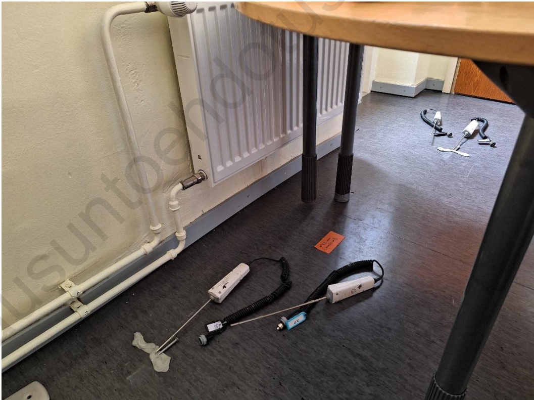
Kuva 14. Kaksi viiltomittausta muovimaton alta. Viiltomittauksissa mittalaite on tiivistetty kitillä muovimaton pintaan ja maton alla oleva herkkä anturikärki on tuettu rautanaulalla. Jokaisen viiltomittauksen kohdalta mitataan mittausolosuhde tarkempaa tulostentulkintaa varten.
