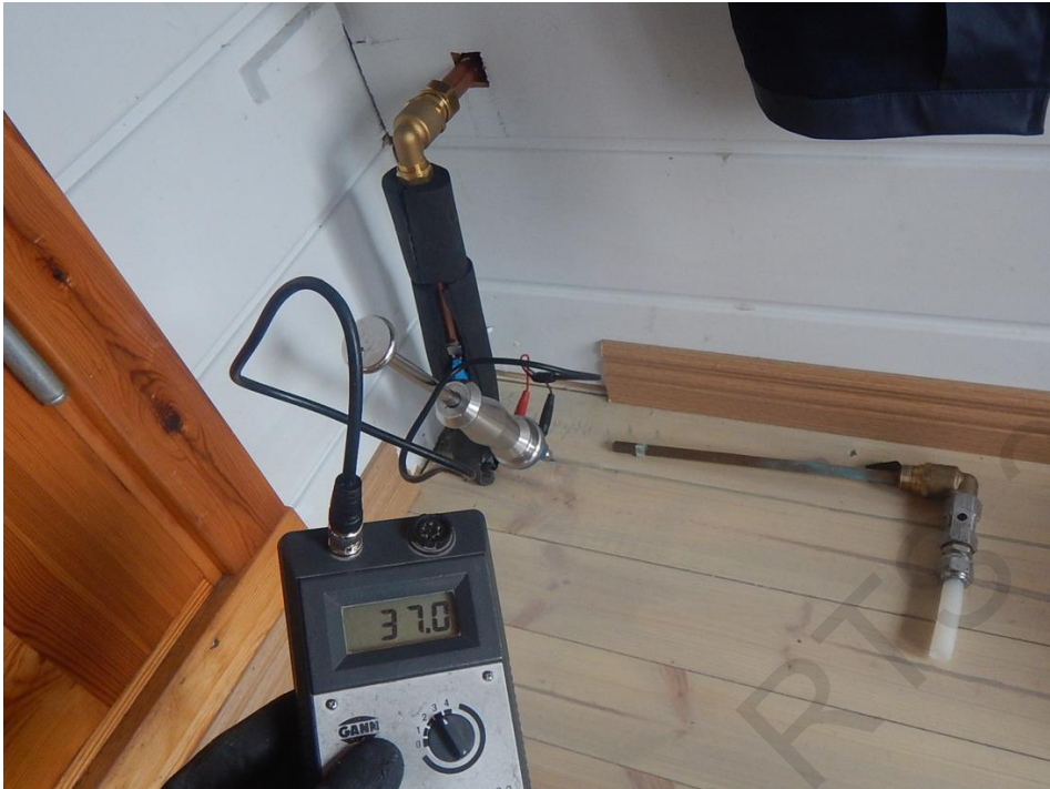
Kuva 12. Putkivuodon kastelemien rakenteiden kartoitus. Piikkimittaus lattian ponttilankun saumasta.
