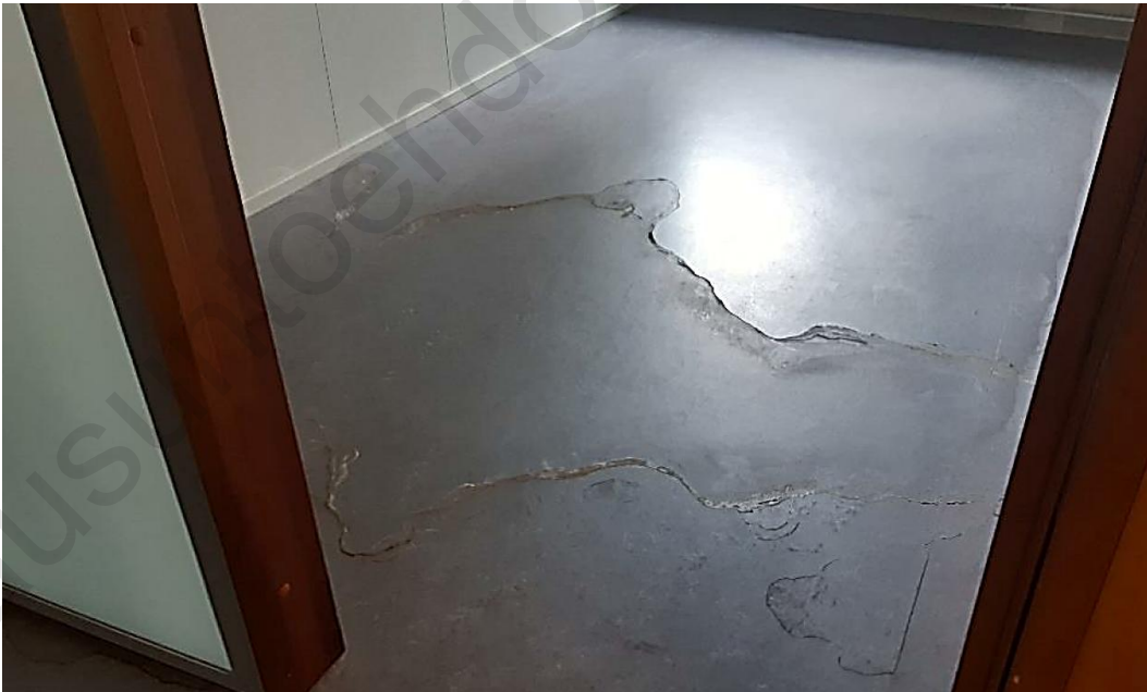
Kuva 5. Patteriputken vuodon aiheuttama kuivunut vesilammikko toimistotiloissa. Vuotovesi on kulkeutunut huoneesta toiseen väliseinien alta epätasaisesta pintavalusta johtuen varsinaisen vahinkotilan viereiselle alueelle.
