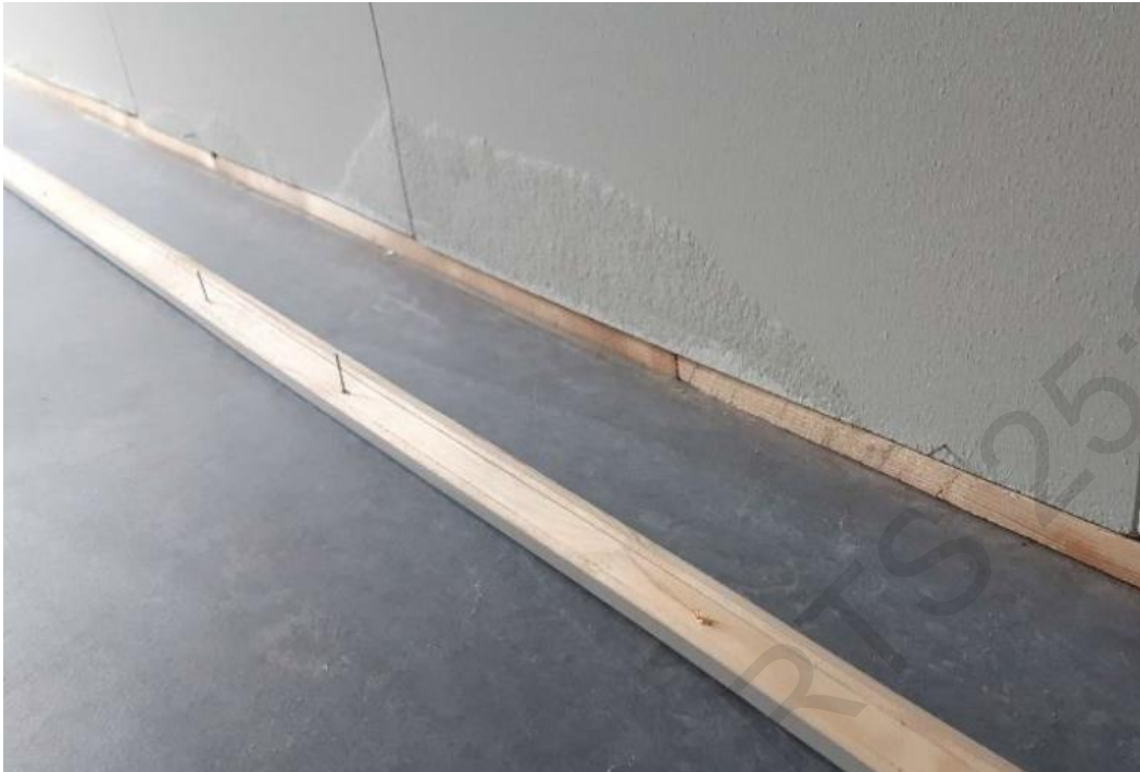
Kuva 6. Väliseinän alaosa on kastunut vuodon seurauksena. Jalkalista ja alaohjauspuu ovat kuivuneet ja niissä ei näy merkkejä kastumisesta. Kuitenkin lastulevy on turvonnut kastumisen seurauksena.
