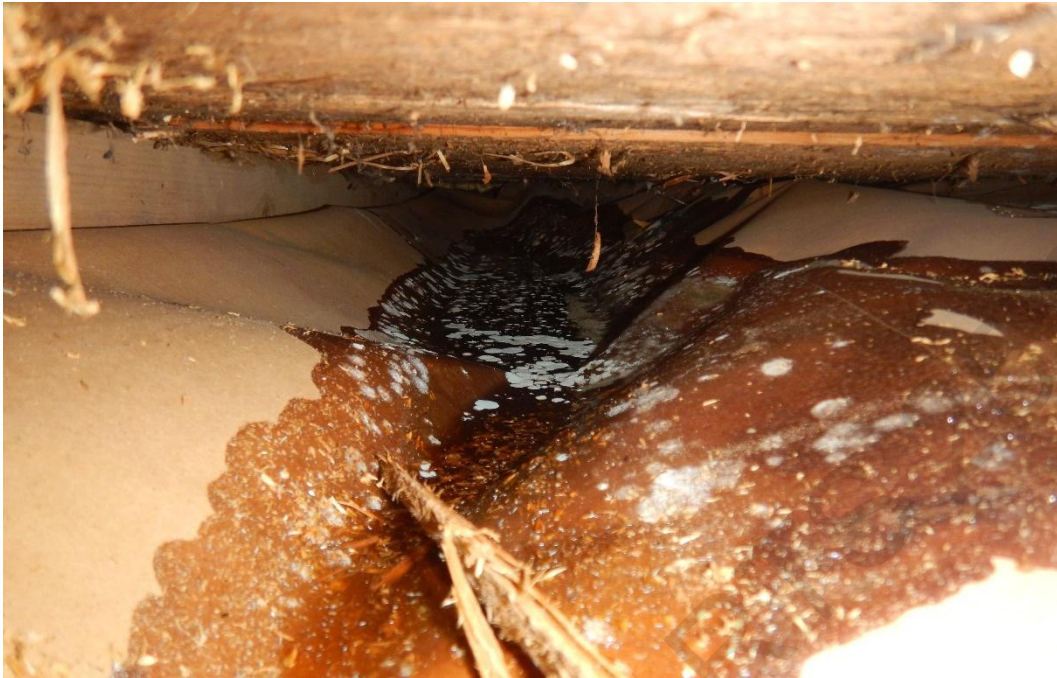
Kuva 9. Rasiaporalla tehdyn tarkastusreiän kautta otettu kuva lankkulattian ja ilmansulkupahvin välistä. Vuotovesi on kulkeutunut ulkoseinälinjalta keskelle huonetta alapohjarakenteen epäjatkuvuuskohdista.
