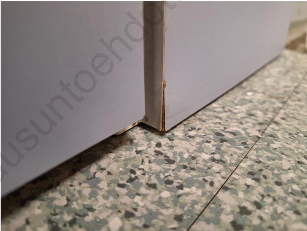
Kuva 3. Kalustelevy on turvonnut ja levynta auennut alaosan kastumisen seurauksena.
