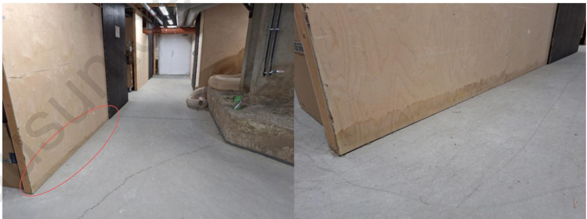
Kuva 20. Esimerkki vahinkoalueen dokumentoinnista. Vahinkoalueen yleiskuvaa voidaan täydentää yksityiskohtaisista havainnoista otetuilla valokuvilla. Vuotovesi on poistettu nopeasti ja lattiat kuivattu. Vaneripintaisessa väliseinässä nähdään kuitenkin vuotoveden aiheuttamia kastumisjälkiä. Kosteus on siirtynyt kapillaarisesti levyssä ylemmäksi lattiapinnasta.
