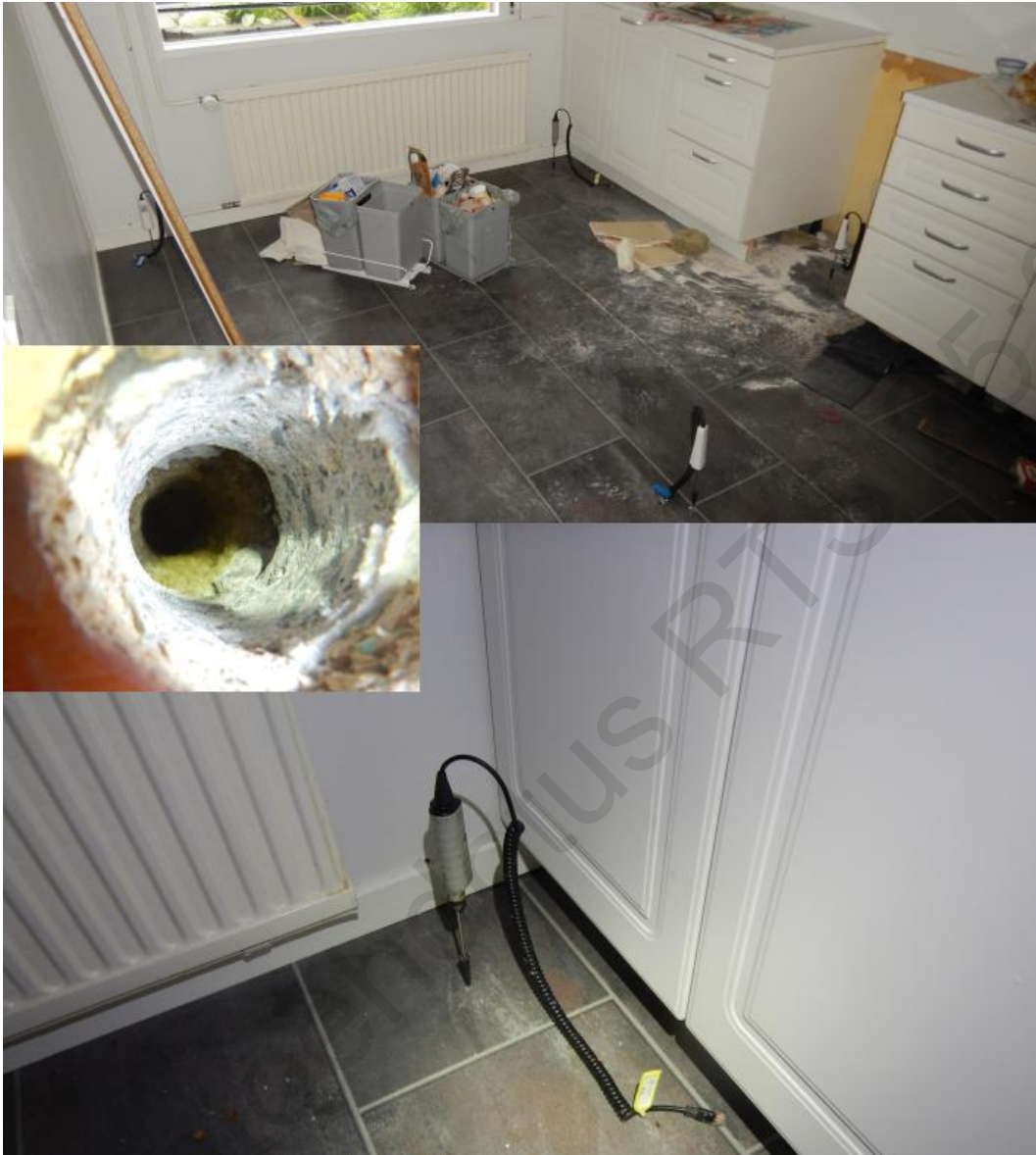
Kuva 16. Vesivahingon laajuuden kartoittaminen lyhytkestoisilla kosteusmittauksilla alapohjarakenteesta pintamateriaalien läpi. Alapohjarakenne on tarkastettu tähytysreiän kautta ja todettu betonilaatan alla olevan lämmöneristeenä mineraalivilla. Vahingon laajuutta on kartoitettu betonin läpi porattujen 5 mm reikien kautta. Mittauksen tavoitteena on verrata mineraalivillan kosteustasoa vahinkoalueen ulkopuolelta tehtyihin referenssimittauksiin.
