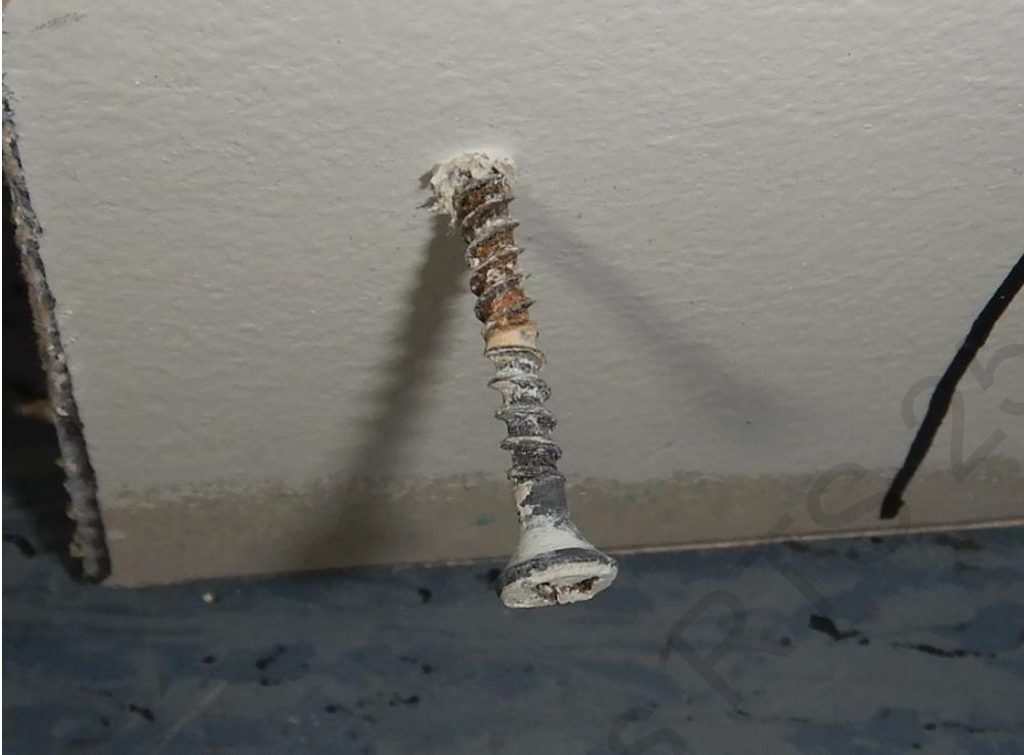
Kuva 2. Kipsilevyn kiinnitysruuvi on ruostunut alaohjauspuun kohdalta, mutta kipsilevyn rajoittuva osa ruuvista on ruosteeton. Havainto viittaa siihen, että alasidepuu on ollut pidempään kostea.
