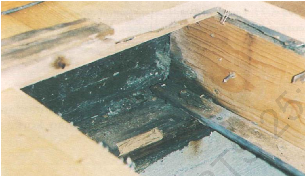
Kuva 22. Esimerkki vahingosta johtumattomasta vaurioitumisesta. Puualapohjan ja betoniperusmuurin vaurioitunut liitiskohta, jossa sisäilman kosteus on tiivistynyt kylmän rakenteen pintaan ja aiheuttanut vaurioitumista. Vaurio on syntynyt pitkän ajan kuluessa.
