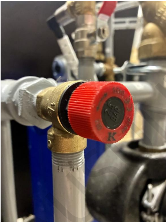
Kuva 10. Lämmitysverkoston varoventtiili, jonka avautumispaine on 2,5 bar.
