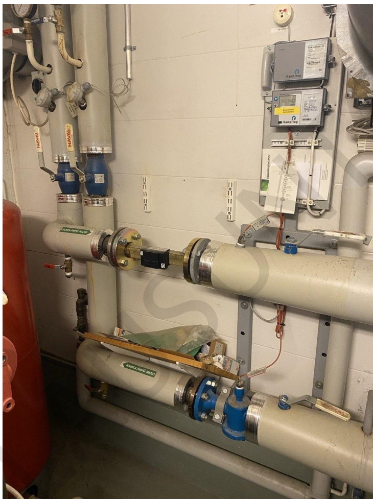
Kuva 12. Kaukolämmön mittauskeskus. Ensimmäisen puolen lianerotin kuvan alemmassa putkessa, eli tuloputkessa (kaukolämpö meno). Lämmönmyyjän energiamittarin virtausanturi kuvan ylemmässä putkessa, eli paluuputkessa (kaukolämpö paluu).
